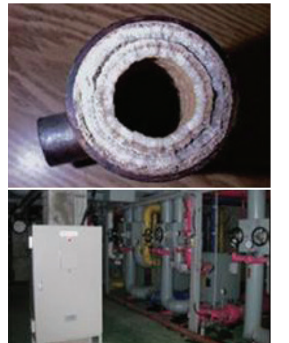
〈스케일 배관과 개발 제작된 스케일 제거장치〉
