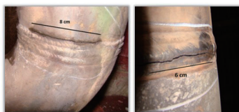
<발전용 튜브 용접부 균열>
