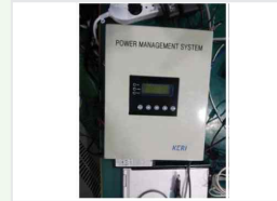
독립형 마이크로그리드 제어용으로 적용되는 전력관리시스템 (Power Management System)
