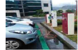
전기자동차 완속충전기 전기안전 및 원격 모니터링
